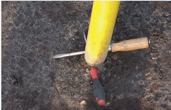
Korrosion im Metallstandpfosten
