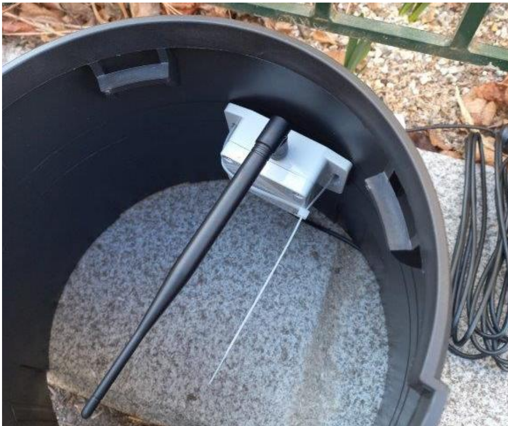
Abb. 3: Funksender verbaut in einem unterirdischen Bodentank - Foto Bundeshauptstadt Wien
