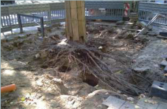
Abb. 9: Bauliche Eingriffe im Wurzelraum kollidiert mit weitstreichenden Wurzelwerken; Verletzungen sind hier zu erwarten (Foto: Gerhard Doobe, Hamburg)
